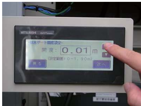
現場操作盤内のゲート操作
